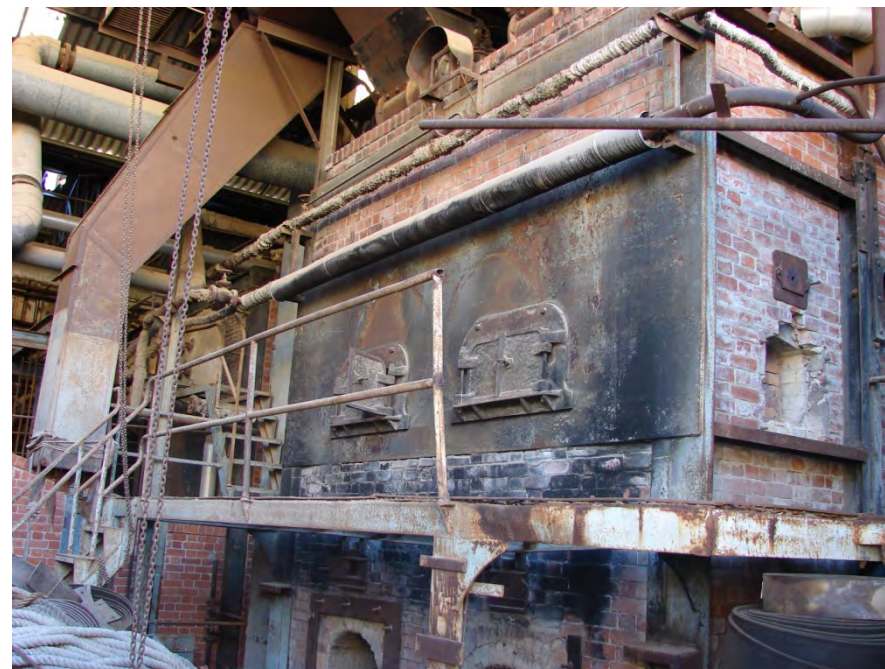
Calderas de las naves centrales de la Fábrica de Ntra. Sra. del Pilar (2013)
